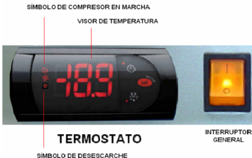
Cuadro de mando con interruptor y termostato
