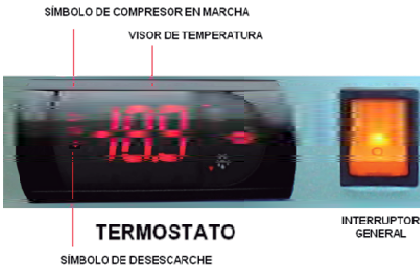
Cuadro de mando con interruptor y termostato
